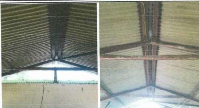
Foto 2: Se observa deterioro por comején, Sustitución de costaneras metálicas
