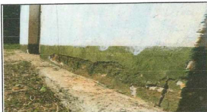
Foto 4: Se observa deterioro de las paredes, Reparación de paredes de 3 aulas.
